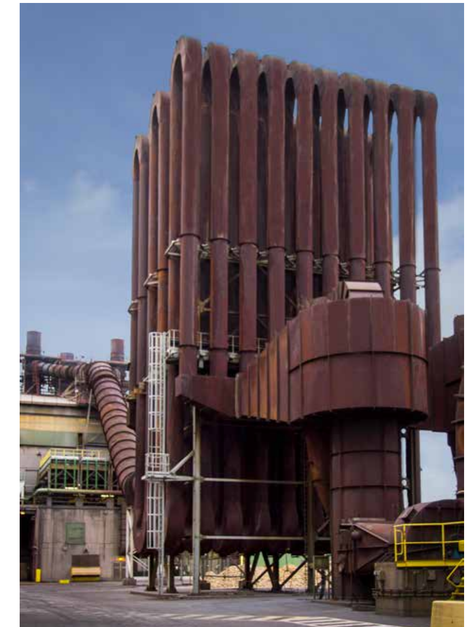
Reykhreinsivirkin hreinsa kísliryk frá ofnum. Kíslirykið er selt og notað til að auka styrk í sementsblöndu.
